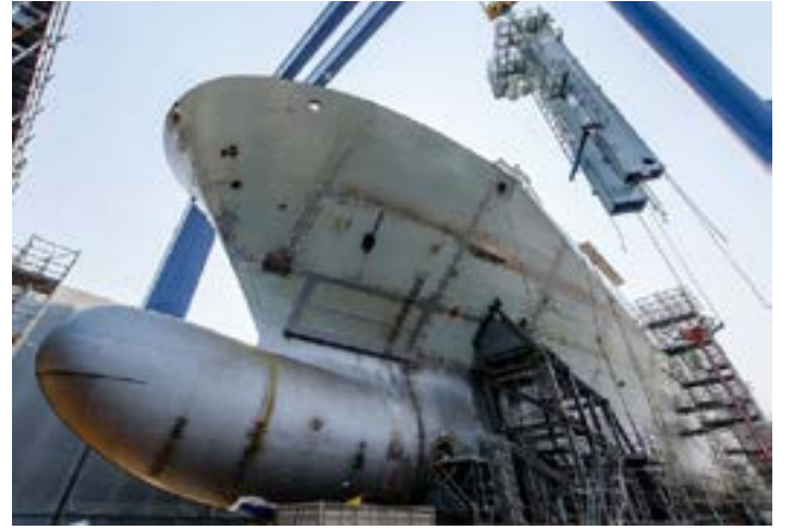
Vue de fond de la coque du futur NCSM Protecteur, le plus long navire jamais construit au Canada.
